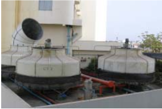
หอผึ่งเย็นของอาคารแห่งหนึ่ง (cooling tower)
